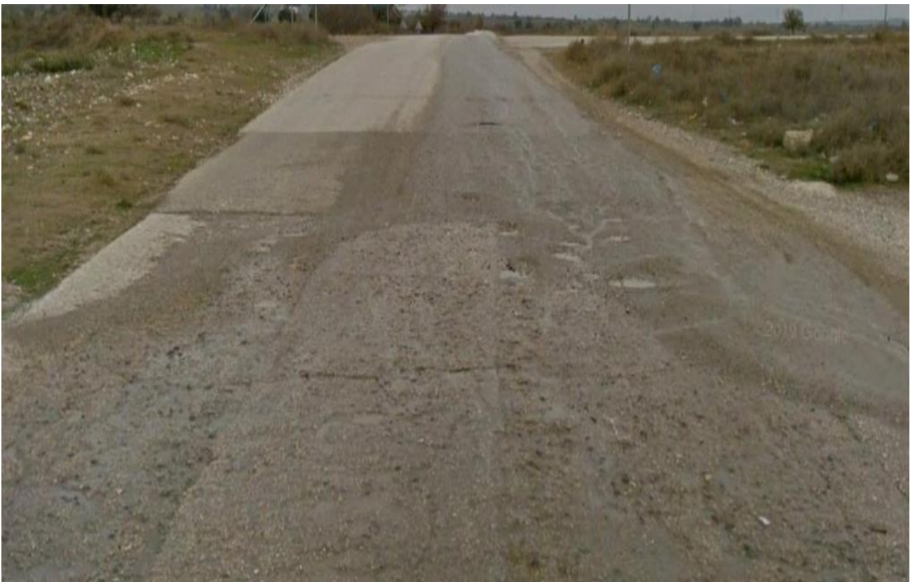
Φωτ. 4: Τοπικές βλάβες και προβληματική συναρμογή στρώσεων σκυροδέματος και ασφαλτικής στρώσης κυκλοφορίας στην έξοδο Ιρλανδικής διάβασης Μακροποτάμου προς Δοκό
