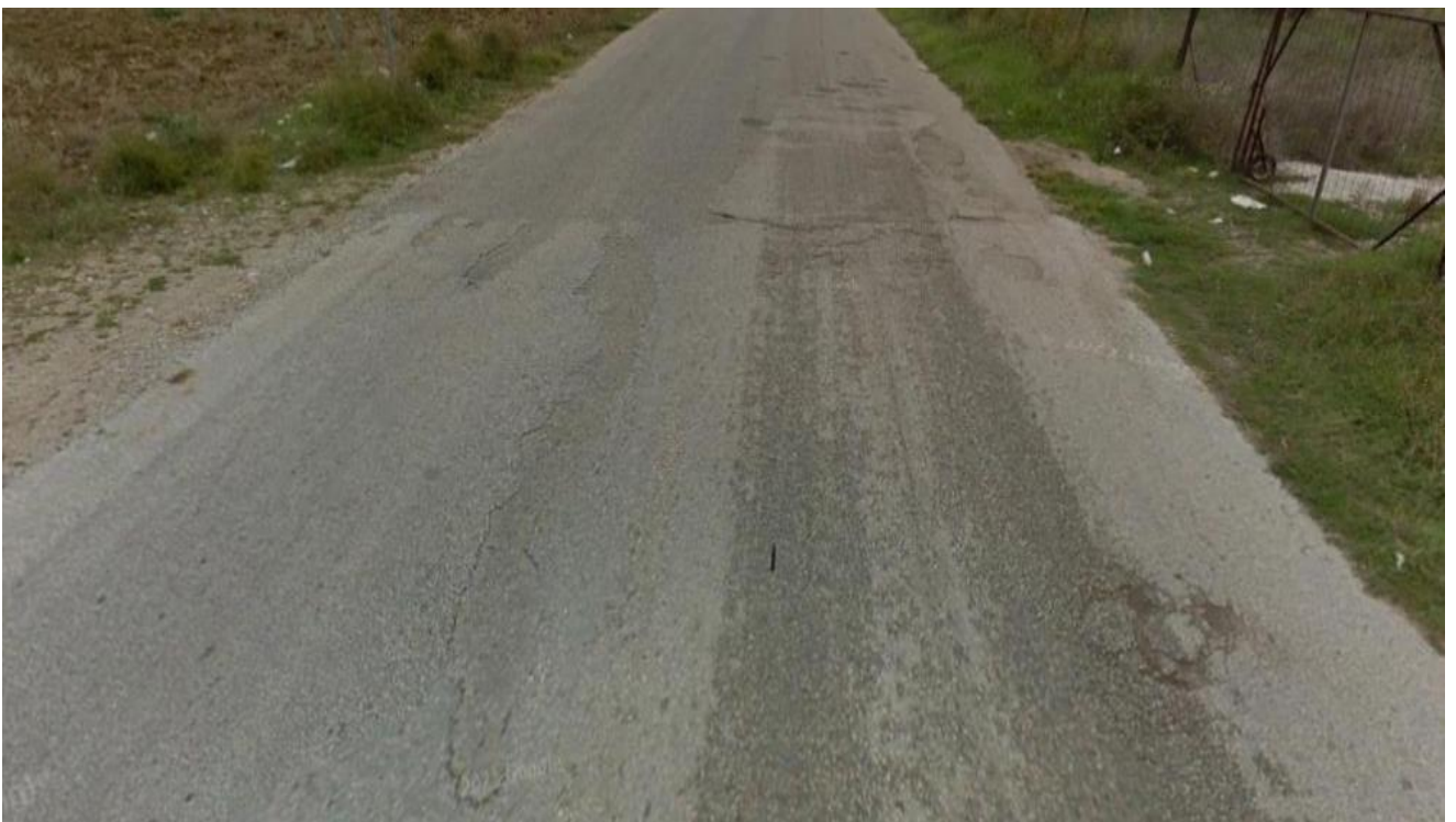
Φωτ. 2: Τοπικές βλάβες στην έξοδο της Ιρλανδικής διάβασης Βοσβόζη
