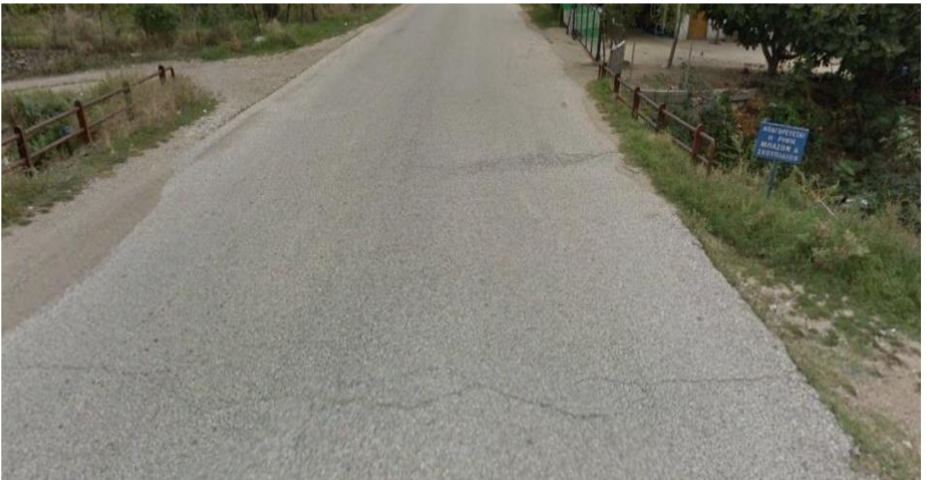
Φωτ. 6: Καθίζηση επιχώματος σε τεχνικό στην έξοδο Φιλλύρας προς Αρριανά
