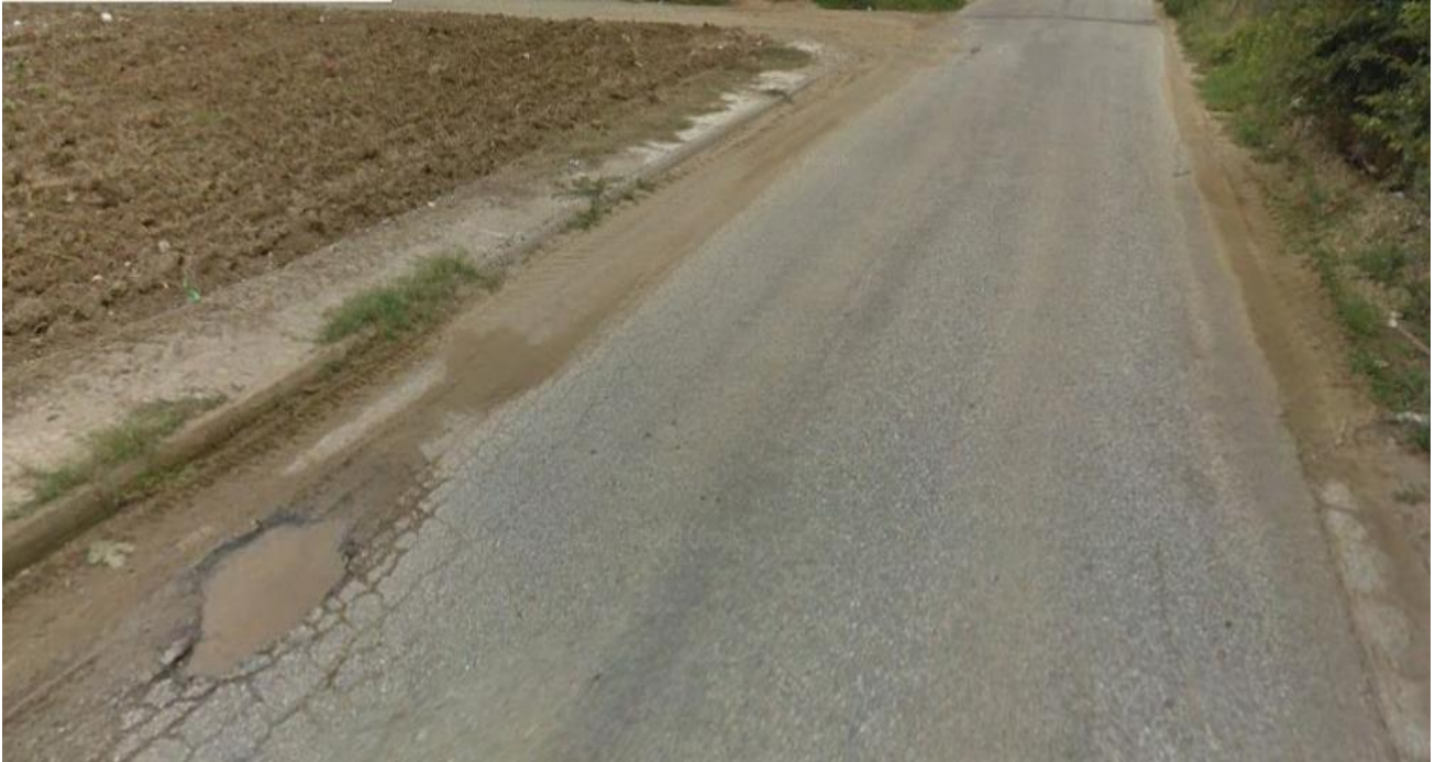
Φωτ. 3: Τοπικές βλάβες και προβληματική απορροή υδάτων εντός οικισμού Στυλαρίου
