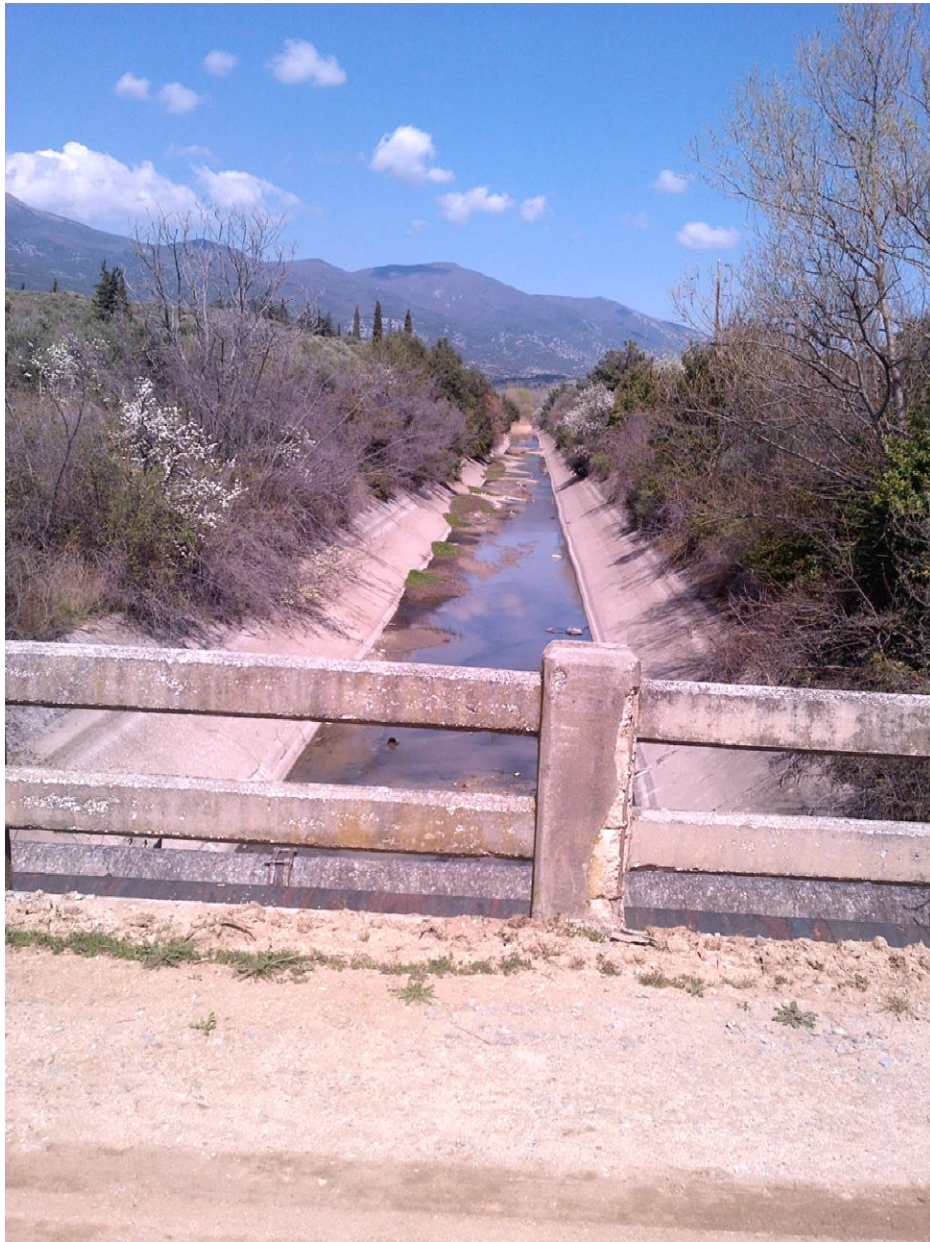
Φωτ. 1: Όψη Κεντρικού Προσαγωγού Από Γέφυρα πλησίον Κεφαλής με έντονη βλάστηση εντός της κοίτης.
