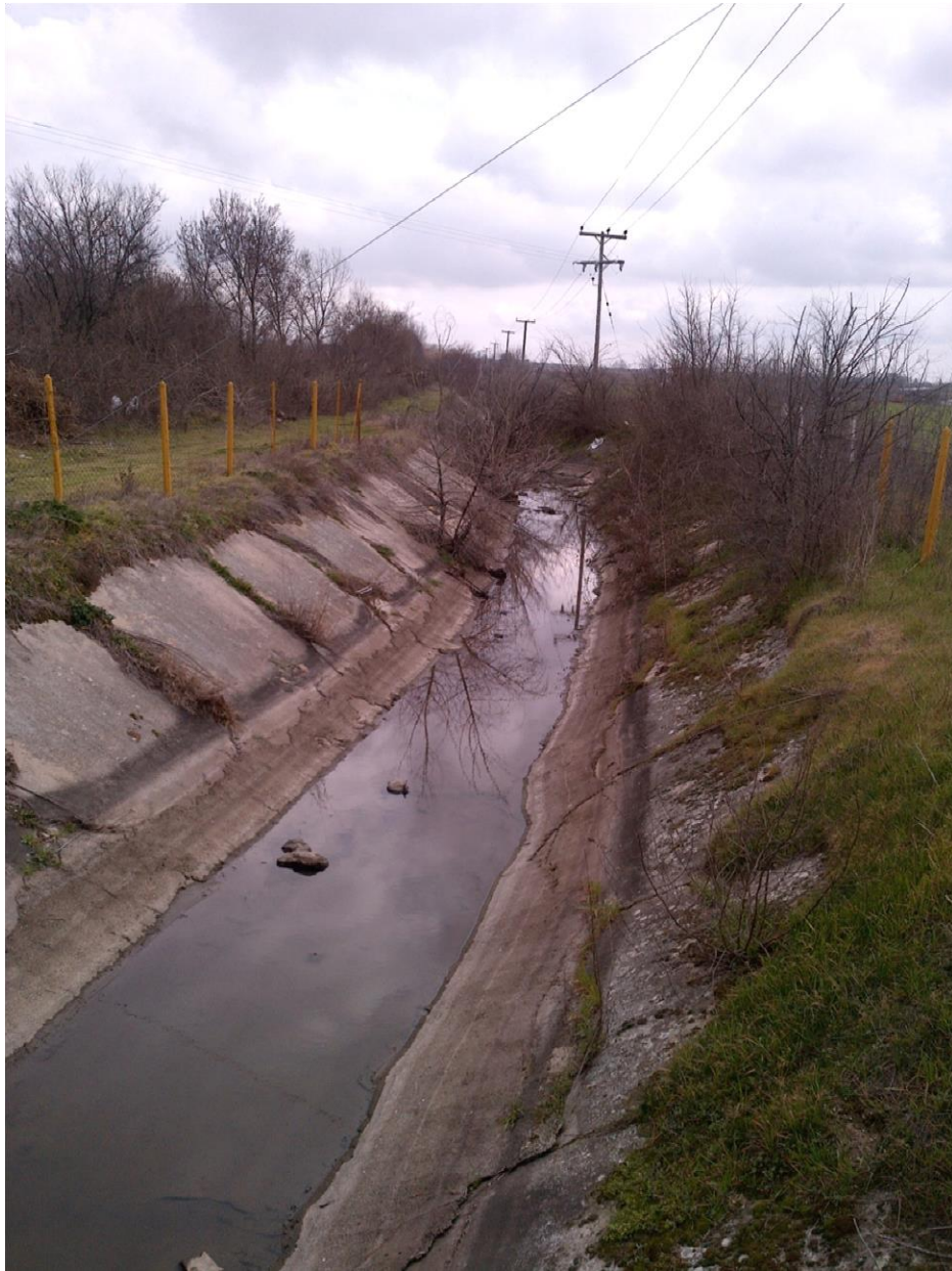
Φωτ. 11: Όψη ανατολικής διώρυγας με ανάγκη καθαρισμού και επιδιόρθωσης της επένδυσης των πρανών.
