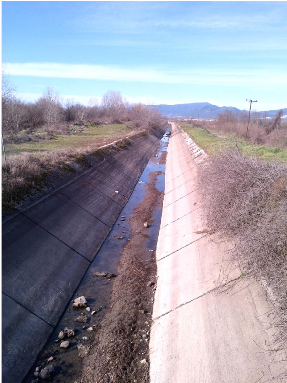
Φωτ. 13: Όψη ανατολικής διώρυγας με ανάγκη καθαρισμού των φερτών υλικών. Η επένδυση των πρανών βρίσκεται σε καλή κατάσταση.
