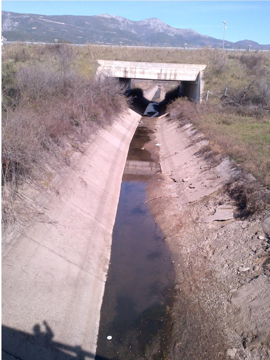
Φωτ.15: Όψη ανατολικής διώρυγας με ανάγκη καθαρισμού και επιδιόρθωσης της επένδυσης των πρανών από την ανατολική όχθη, πλησίον της αερογέφυρας της Εγνατίας Οδού.
