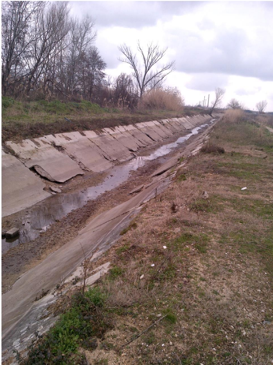
Φωτ. 12: Όψη ανατολικής διώρυγας με ανάγκη ολικής αποκατάστασης.
