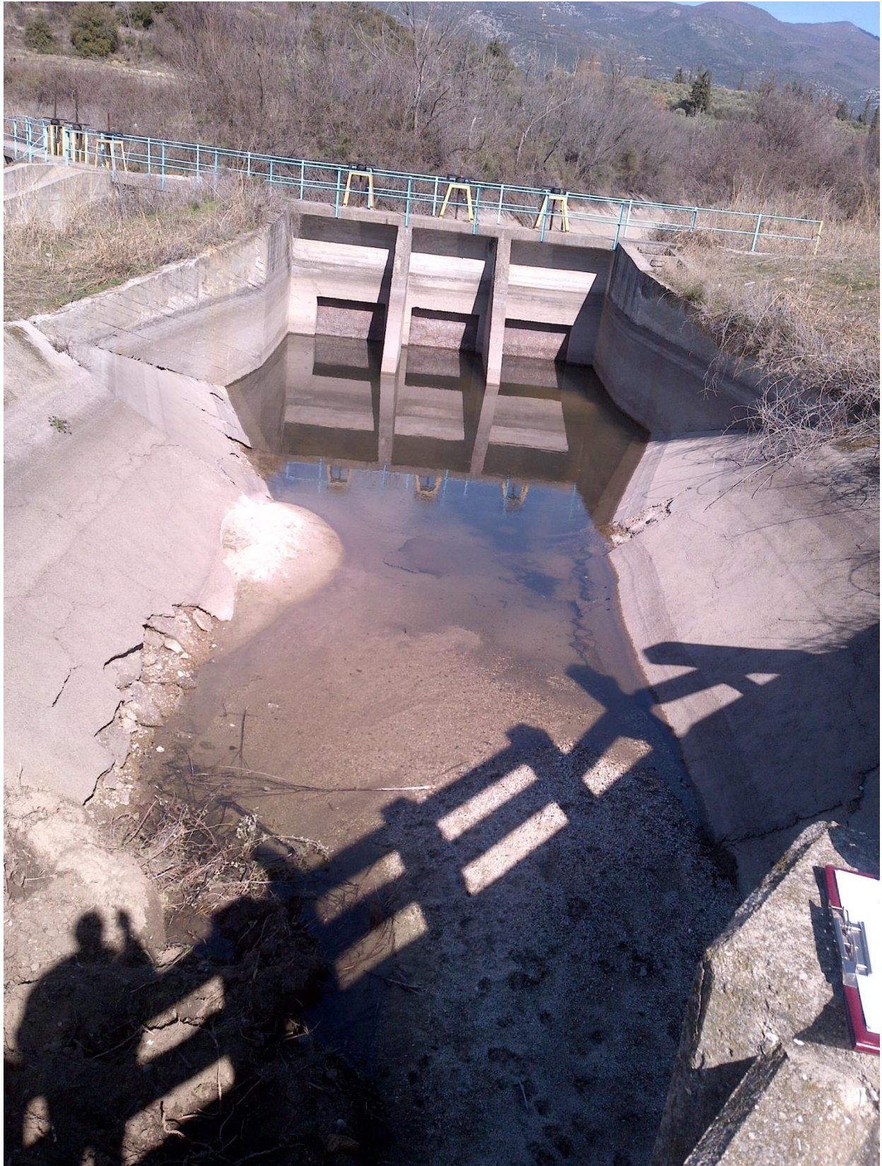
Φωτ. 16: Όψη ανατολικής διώρυγας και συγκεκριμένα των θυροφραγμάτων στην κεφαλή διαμέρισης ύδατος. Υπάρχει ανάγκη καθαρισμού του πυθμένα και επιδιόρθωσης των πρανών.
