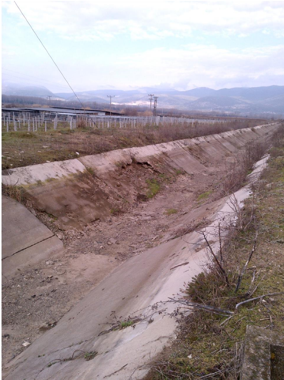
Φωτ. 6: Όψη δυτικής διώρυγας με πλήρως αποσαθρωμένα πρανή με ανάγκη επανεπένδυσης.
