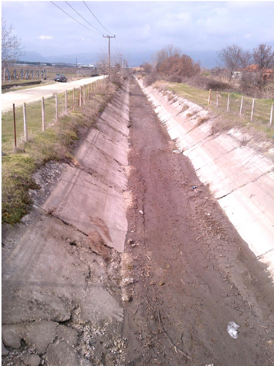
Φωτ. 10: Όψη ανατολικής διώρυγας με ανάγκη καθαρισμού και επιδιόρθωσης της επένδυσης των πρανών.
