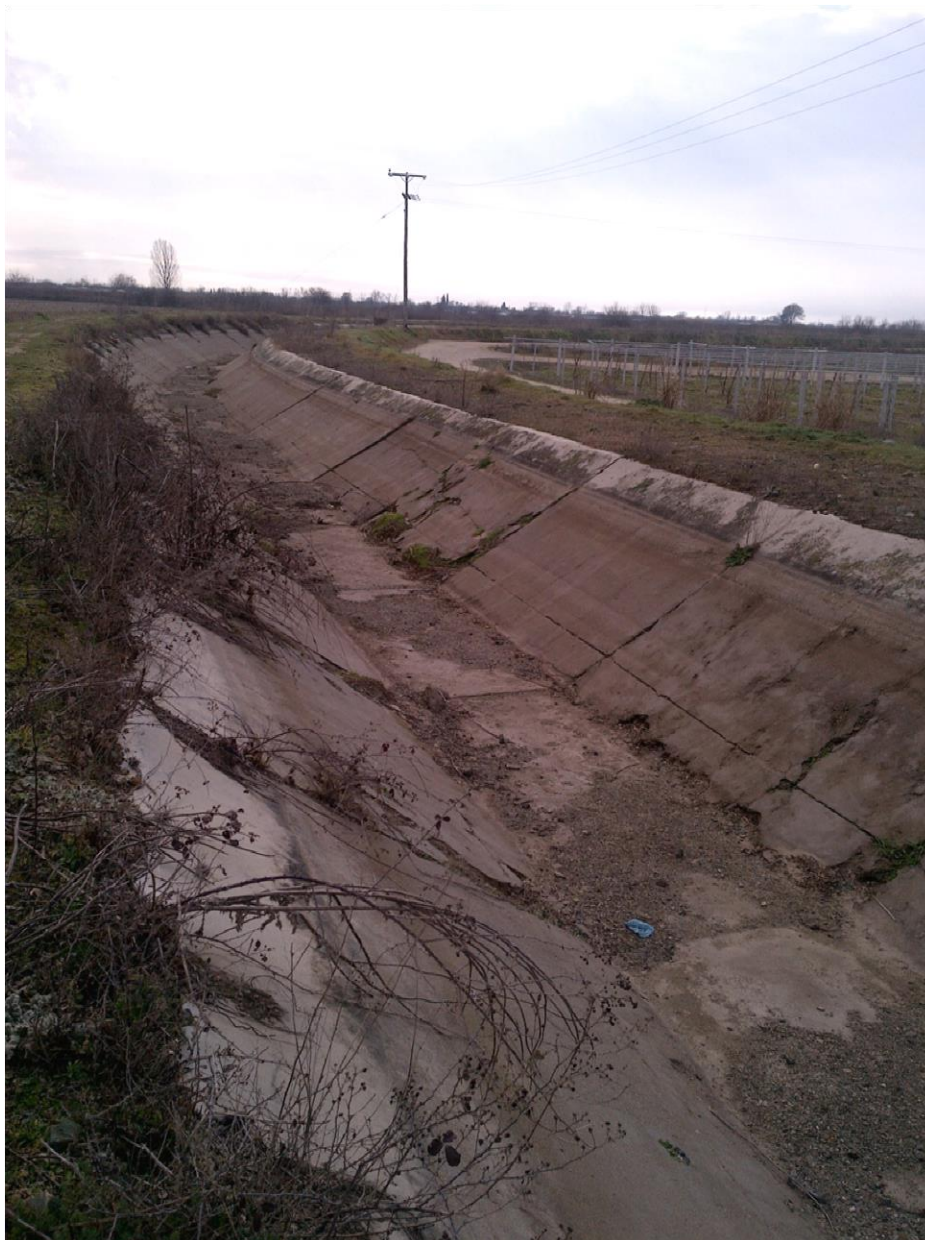
Φωτ. 12: Όψη δυτικής διώρυγας με πλήρως αποσαθρωμένα πρανή με ανάγκη επανεπένδυσης και απομάκρυνση της παρόχθιας βλάστησης.
