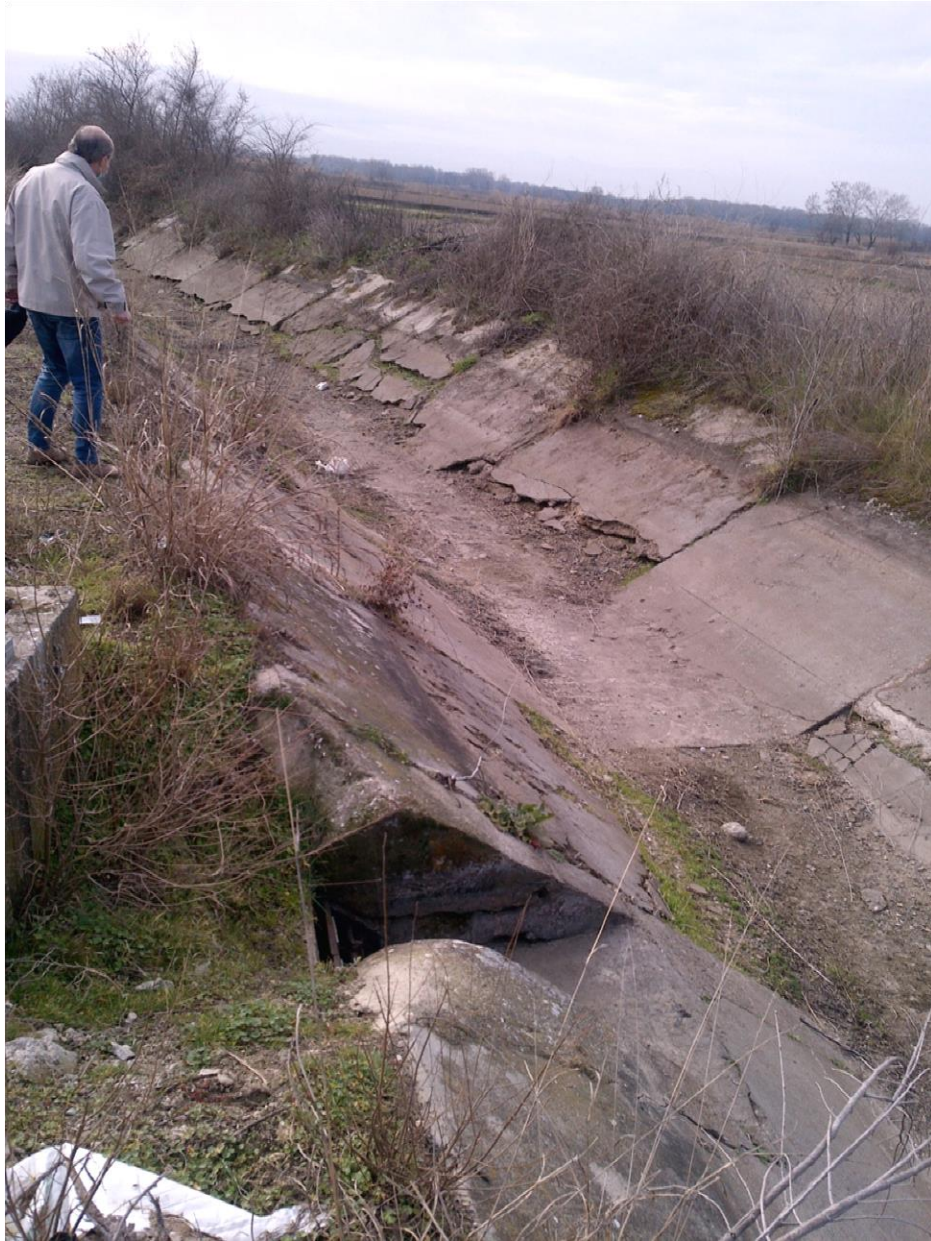
Φωτ. 15: Όψη δυτικής διώρυγας με ανάγκη καθαρισμού και επανεπένδυσης. Όψη εγκάρσιου υπερχειλιστή ο οποίος υδροδοτεί το τριτεύων αρδευτικό δίκτυο.
