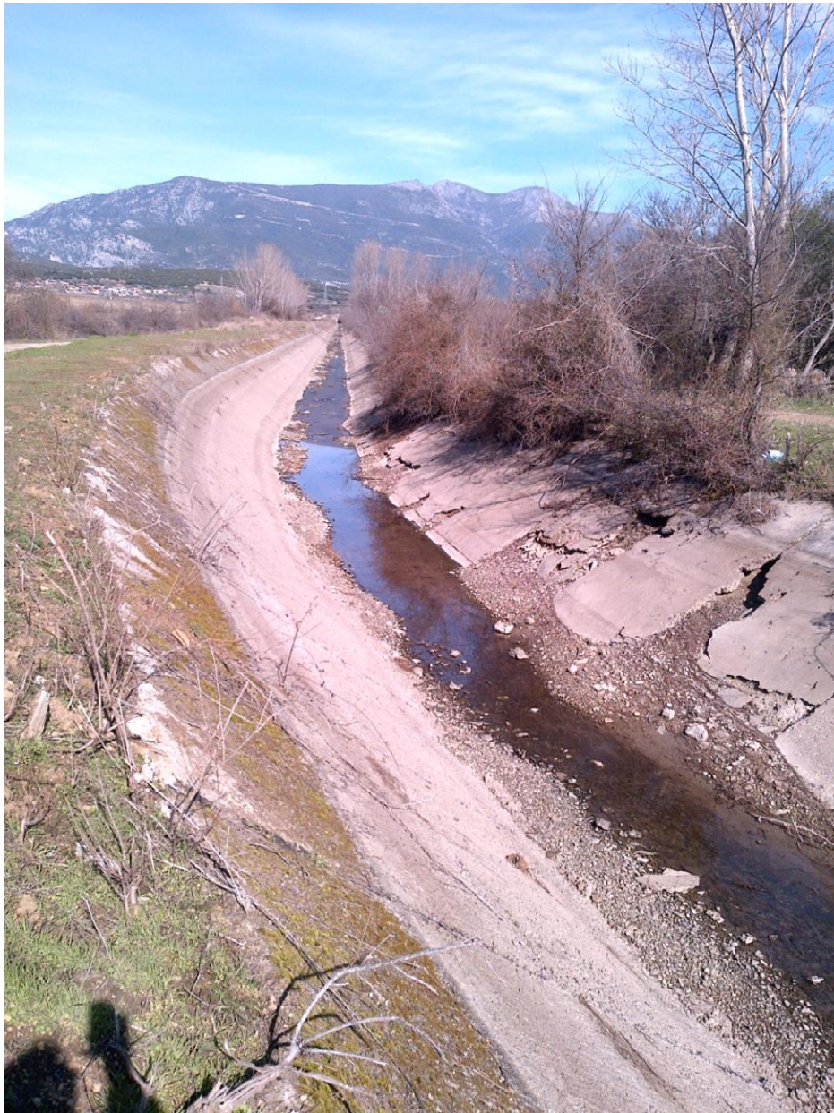
Φωτ. 28: Όψη ανατολικής διώρυγας με ανάγκη καθαρισμού και επανεπένδυσης των πρανών.
