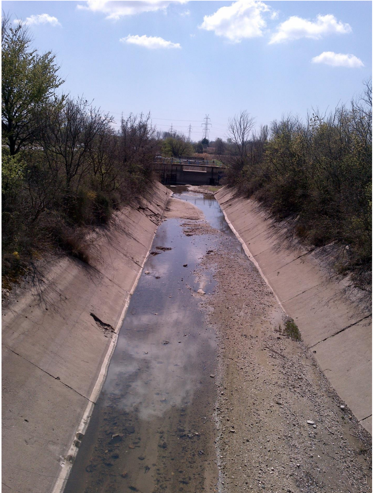
Φωτ. 7: Όψη Κεφαλής Διαμέρισης Ύδατος Στις Κατάντη Διώρυγες Από Τον Κεντρικό Προσαγωγό. Η επένδυση των πρανών εμφανίζει σημειακές βλάβες και υπάρχει όγκος φερτών υλικών εντός της κοίτης.
