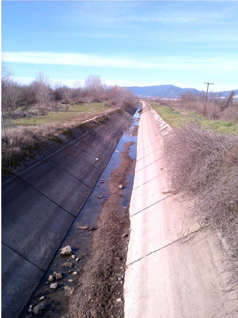
Φωτ. 26: Όλη ανατολικής διώρυγας με ανάγκη καθαρισμού των φερτών υλικών. Η επένδυση των πρανών βρίσκεται σε καλή κατάσταση.
