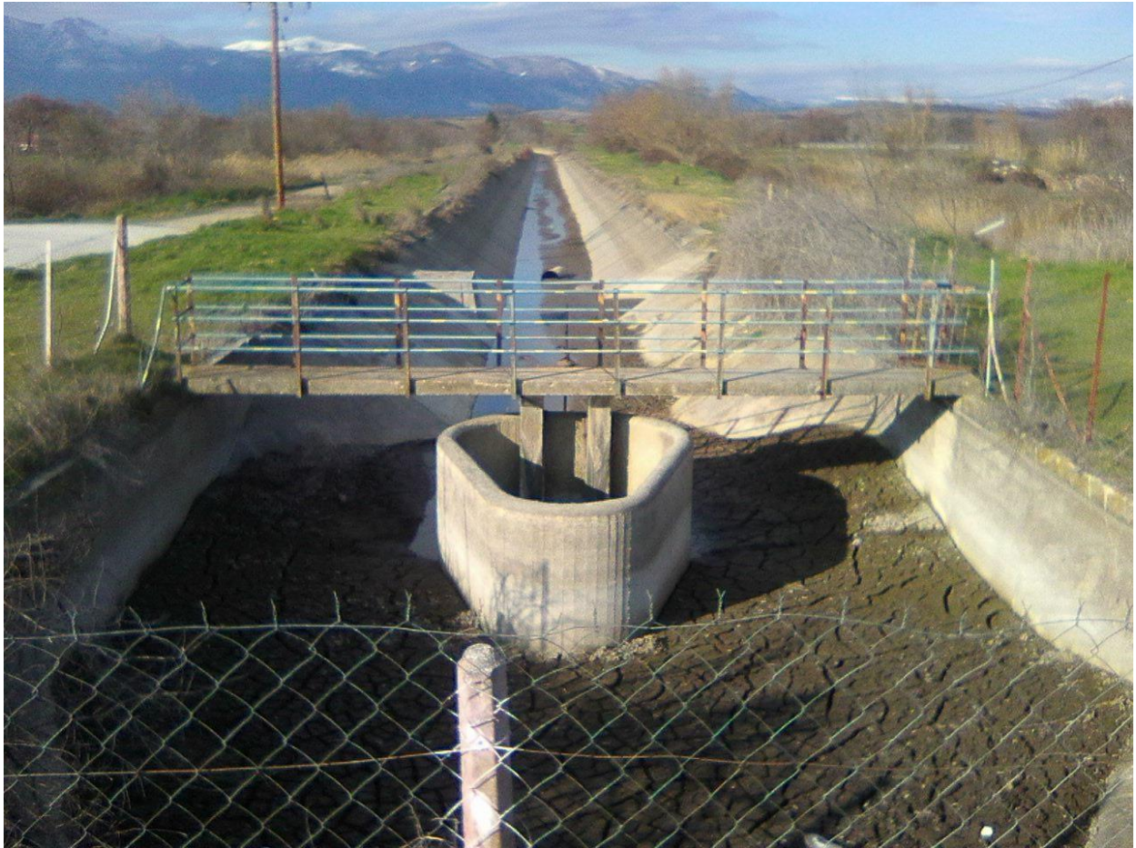
Φωτ. 19: Τερματικό σημείο ανατολικής διώρυγας με ανάγκη καθαρισμού. Εντός το ελλειψοειδούς κάτοψης φρεατίου βρίσκεται αγωγός συνεχούς ροής ό οποίος υδροδοτεί ανατολικό υδατόρεμα.
