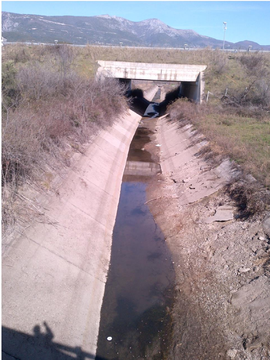
Φωτ. 32: Όψη ανατολικής διώρυγας με ανάγκη καθαρισμού και επιδιόρθωσης της επένδυσης των πρανών, πλησίον της αερογέφυρας της Εγνατίας Οδού.
