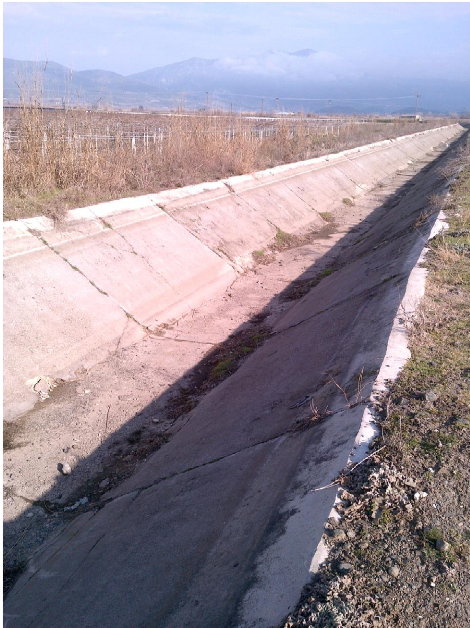
Φωτ. 13: Όψη δυτικής διώρυγας με την επένδυση της διώρυγας να είναι σε καλή κατάσταση.
