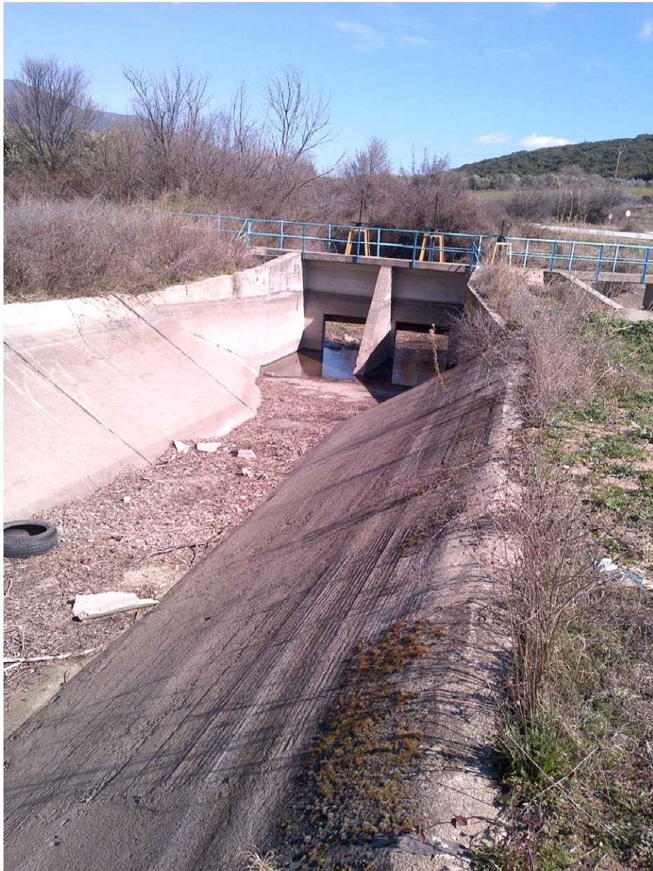
Φωτ. 10: Όψη Θυροφραγμάτων προς τη δυτική διώρυγα. Η κατάσταση των πρανών κρίνεται καλή.
