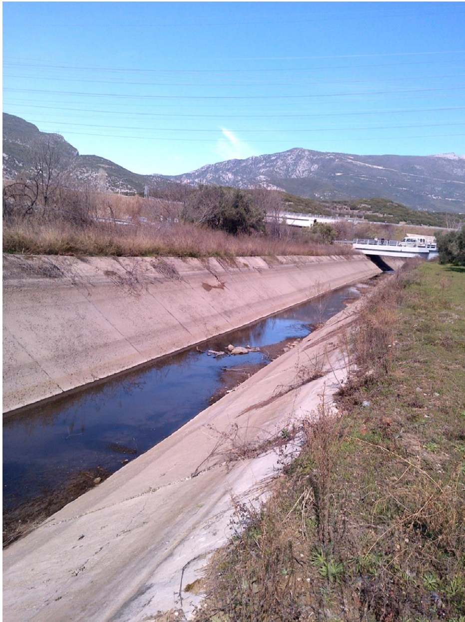
Φωτ. 31: Όψη ανατολικής διώρυγας με ανάγκη καθαρισμού. Η επένδυση βρίσκεται σε καλή κατάσταση. Η λήψη είναι πλησίον της γέφυρας βόρεια του οικισμού της Θαλασσιάς.
