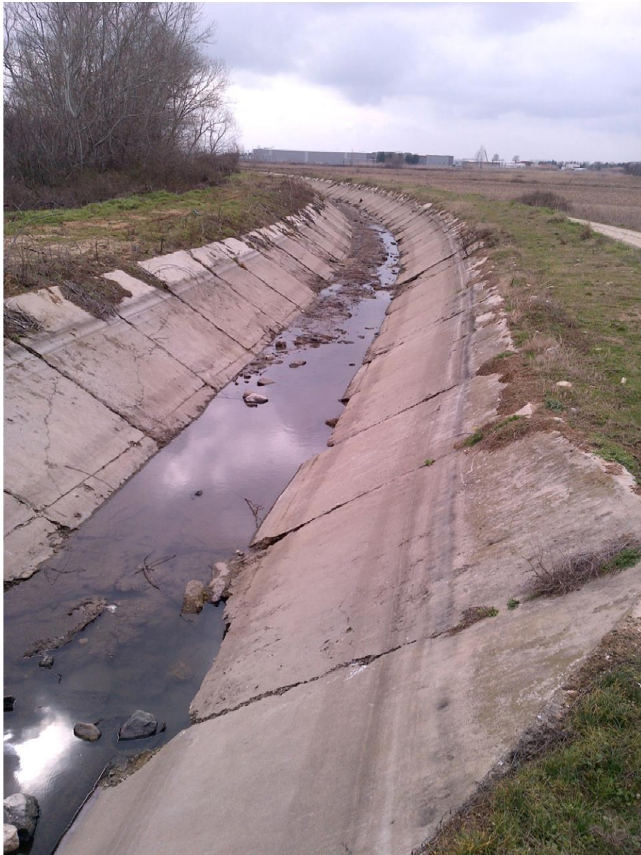
Φωτ. 25: Όψη ανατολικής διώρυγας με ανάγκη καθαρισμού και επιδιόρθωσης της επένδυσης των πρανών.
