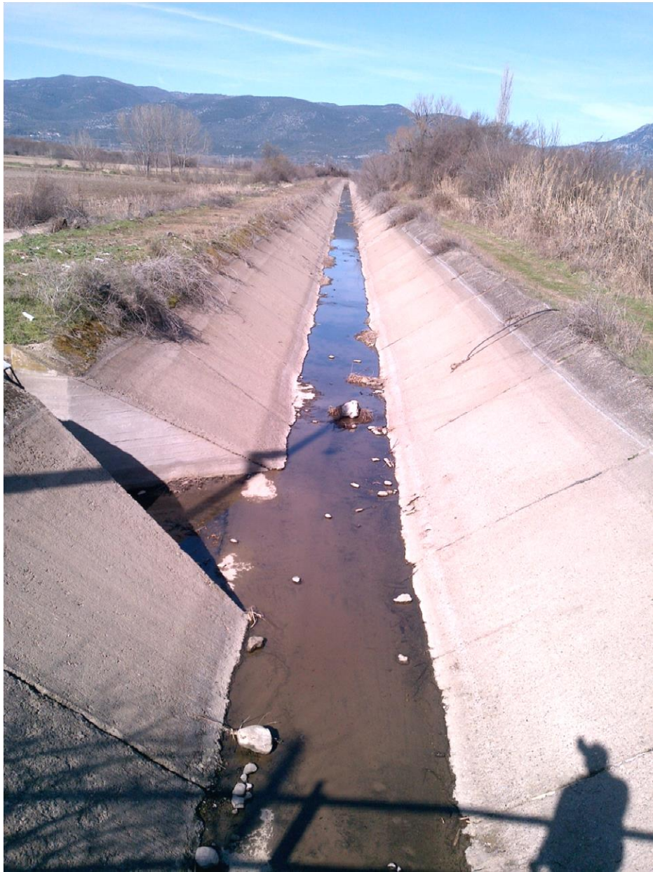
Φωτ. 27: Όψη ανατολικής διώρυγας με ανάγκη καθαρισμού και επιδιόρθωσης της επένδυσης των πρανών. Απεικονίζεται εγκάρσια η απαγωγή ύδατος προς το δευτερεύων δίκτυο.
