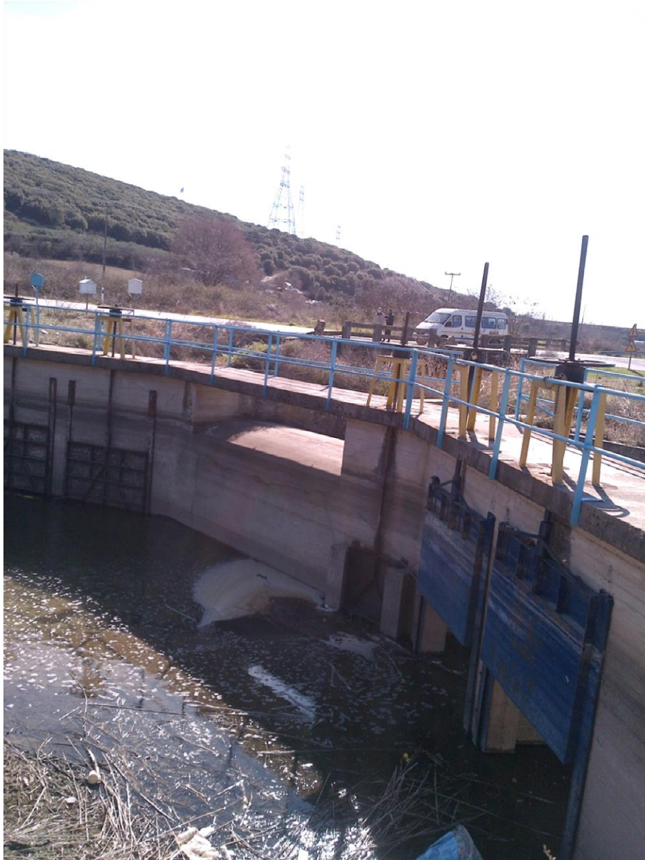
Φωτ. 9: Όψη Κεφαλής Διαμέρισης Ύδατος Στις Καπάνη Διώρυγες Από Τον Κεντρικό Προσαγωγό. Εμφανίζονται τα 2 θυροφράγματα που οδεύουν προς τη δυτική διώρυγα και η οπή υπερχείλισης προς την κεντρική διώρυγα τη «V», καθώς και η μικρή θύρα προς αυτήν. Ύπαρξη πολλών φερτών υλικών στον πυθμένα της κεντρικής διώρυγας και ύπαρξη ανισοσταθμιών στο βάθος πυθμένα.
