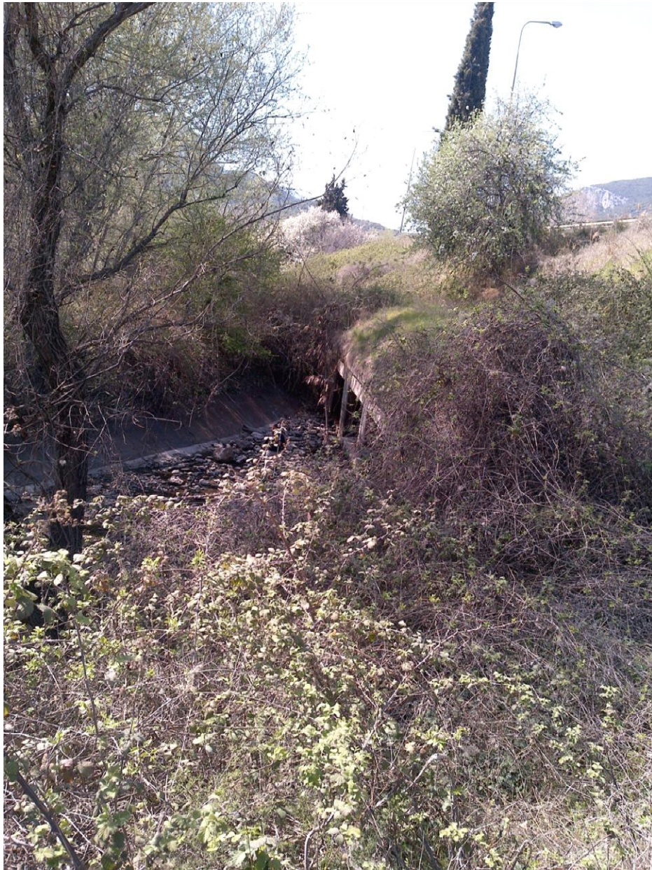
Φωτ. 2: Είσοδος ύδατος κάτω από την Ε.Ο. Ξάνθης Καβάλας στη διώρυγα του κεντρικού προσαγωγού.
