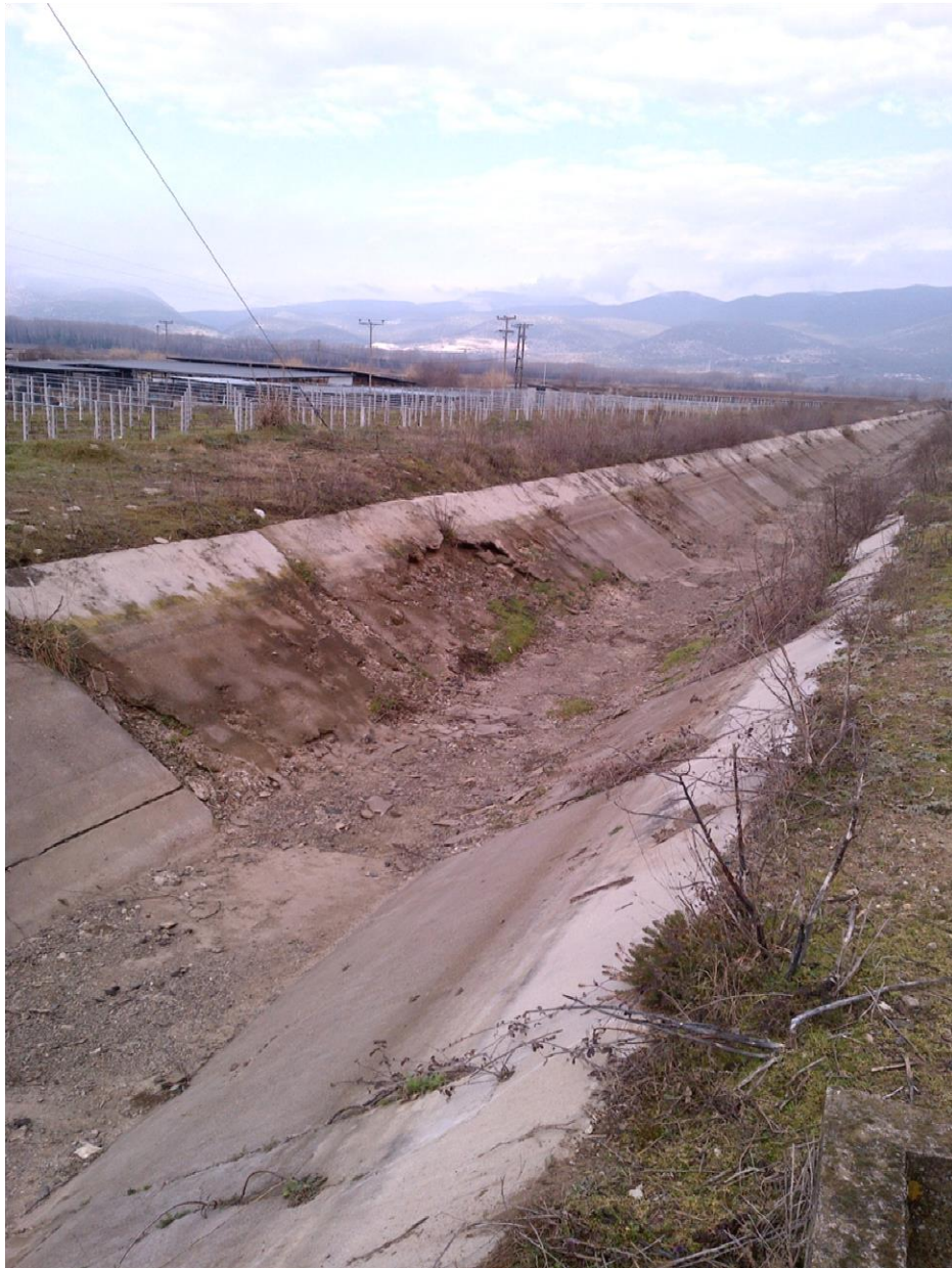
Φωτ. 11: Όψη δυτικής διώρυγας με πλήρως αποσαθρωμένα πρανή με ανάγκη επανεπένδυσης.
