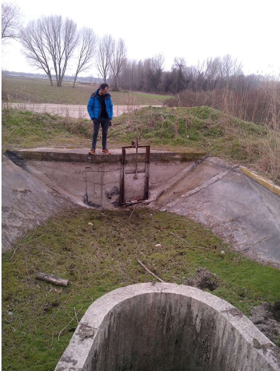
Φωτ. 17: Τερματικό σημείο δυτικής διώρυγας με ανάγκη καθαρισμού. Το θυρόφραγμα οδηγεί σε αγωγό υπερχειλιστικό ό οποίος τροφοδοτεί κατάντι υδατόρεμα.
