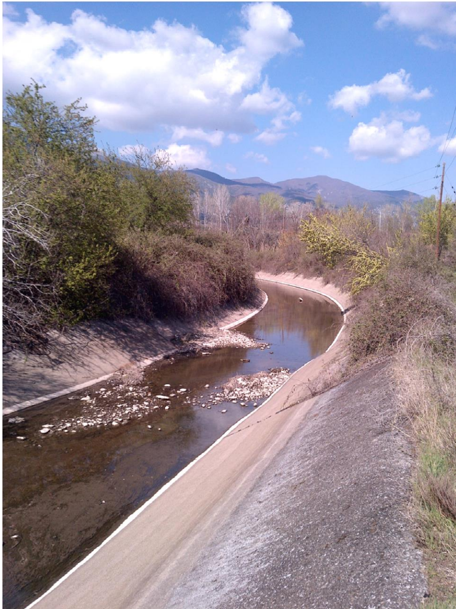
Φωτ. 6: Όψη Κεντρικού Προσαγωγού Με Βλάστηση εντός της κοίτης και φερτά υλικά εντός της κοίτης και σε καλή κατάσταση της επένδυσης των πρανών.
