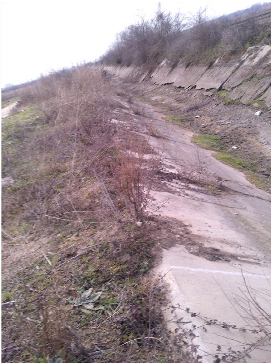
Φωτ. 16: Όψη δυτικής διώρυγας με ανάγκη καθαρισμού και επανεπένδυσης.
