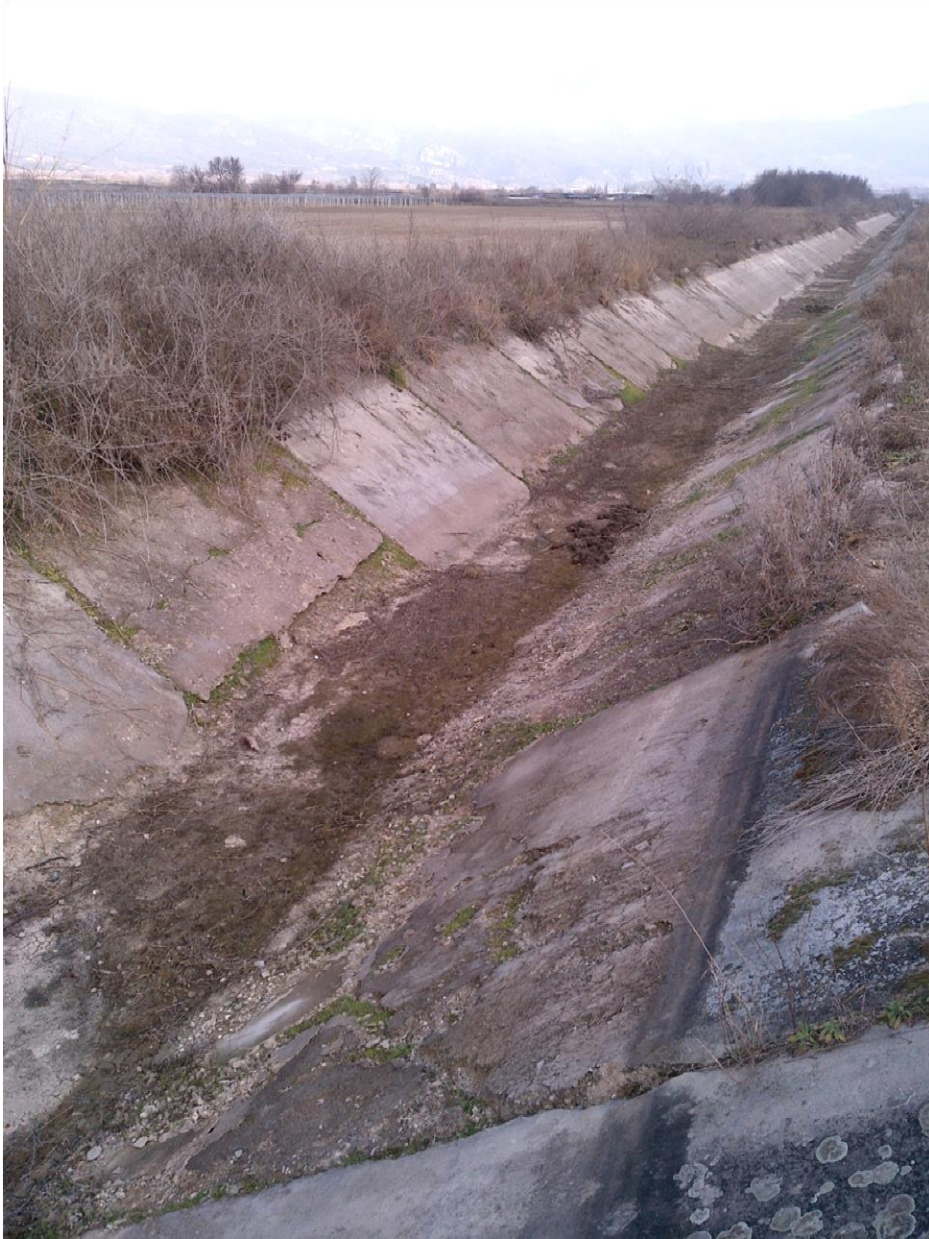
Φωτ. 15: Όψη δυτικής διώρυγας με ανάγκη καθαρισμού και επανεπένδυσης.
