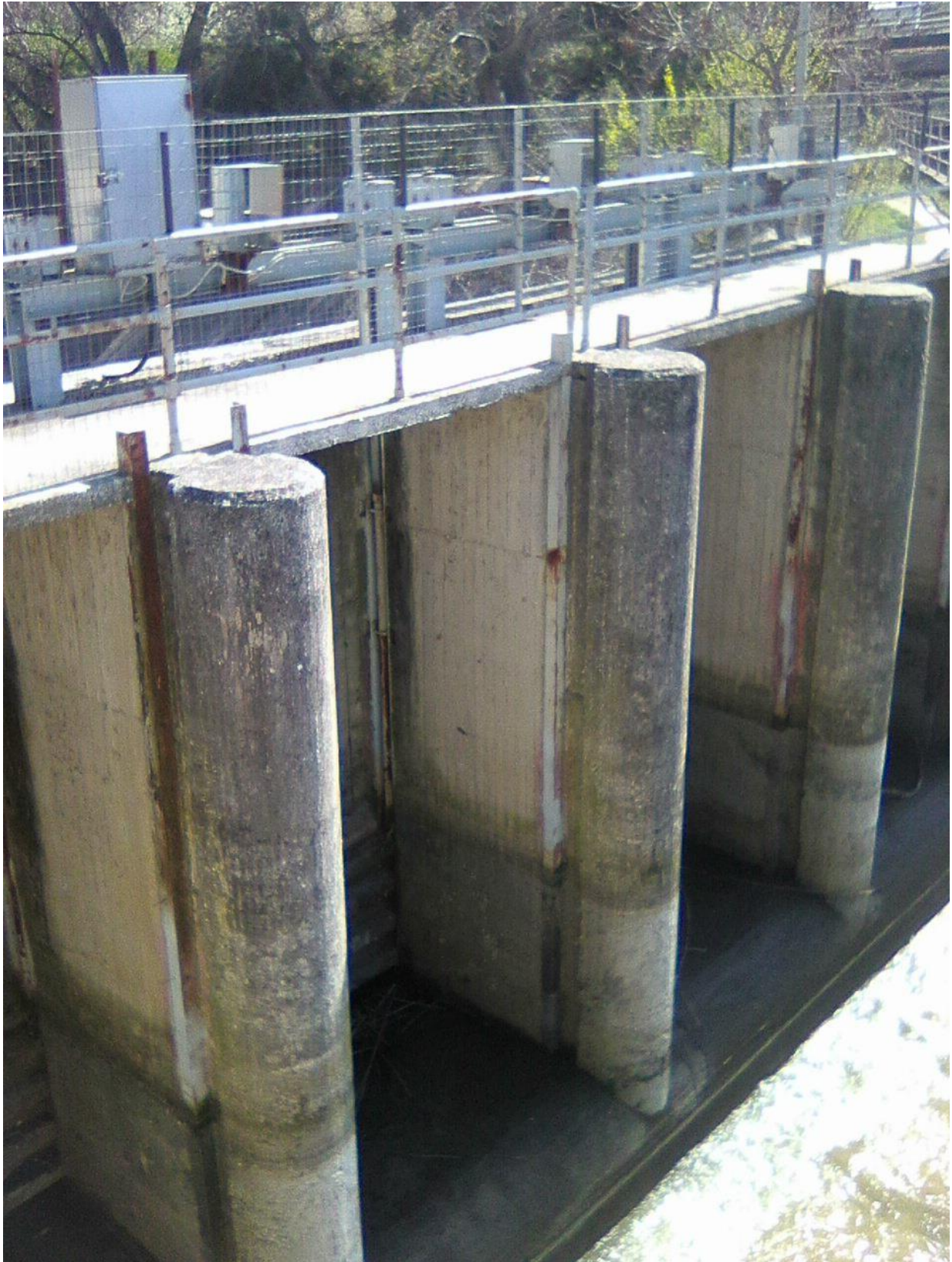
Φωτ. 1: Κεντρικό Θυρόφραγμα Στον Ποταμό Για Εισροή Ύδατος Στον Κεντρικό Προσαγωγό
