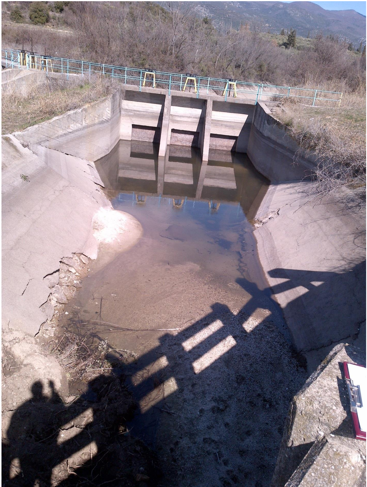
Φωτ. 33: Όψη ανατολικής διώρυγας και συγκεκριμένα των θυροφραγμάτων στην κεφαλή διαμέρισης ύδατος. Υπάρχει ανάγκη καθαρισμού του πυθμένα και επιδιόρθωσης των πρανών.
