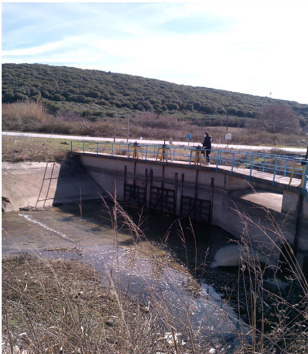
Φωτ. 8: Όψη Κεφαλής Διαμέρισης Ύδατος Στις Κατάντη Διώρυγες Από Τον Κεντρικό Προσαγωγό. Εμφανίζονται τα 3 θυροφράγματα που οδεύουν προς την ανατολική διώρυγα και η οπή υπερχειλίσης προς την κεντρική διώρυγα τη «V». Ύπαρξη πολλών φερτών υλικών στον πυθμένα της κεντρικής διώρυγας και ύπαρξη ανισοσταθμιών στο βάθος πυθμένα.
